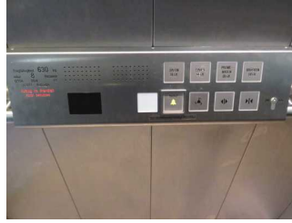
Bedienelement im Aufzug
