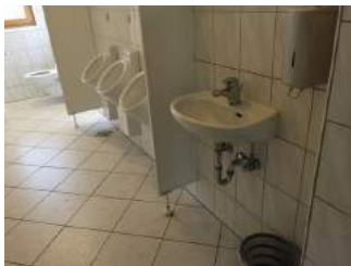
Waschbecken Vorraum Herrentoilette
